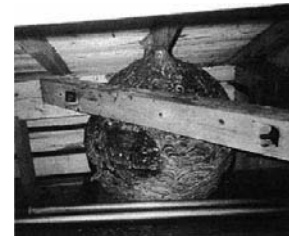
図2 屋根裏のキロスズメバチの巣
